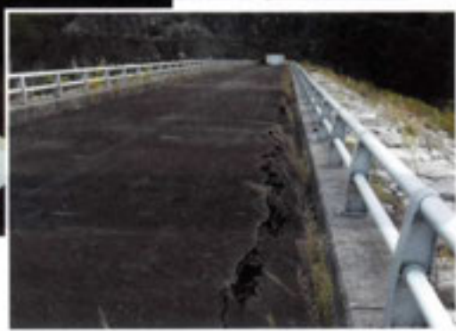
■震災後の 大柿ダムの状況 上流地覆付近のアスファルト面の陥没が見られました。
