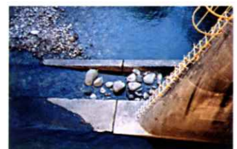
焼築頭首工 堆砂状況
