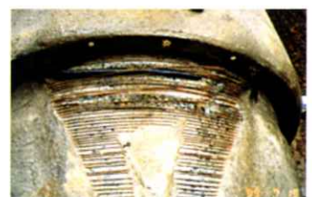
幹線用水路 漏水箇所接写
