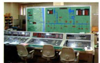
用水管理施設 (ダム操作卓)
